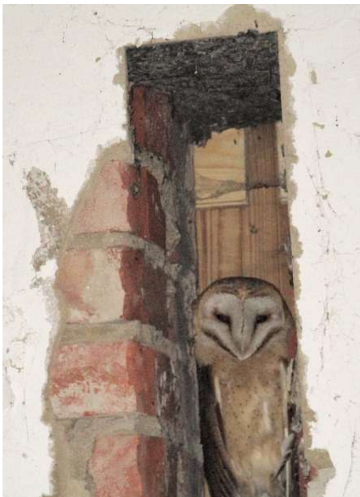
Der erhoffte Gast: Eine Schleiereule hat sich im Schwärmer Trafoturm häuslich eingerichtet.
